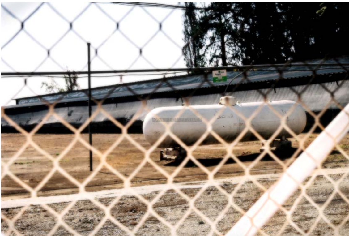
מיכל גז Gas container
